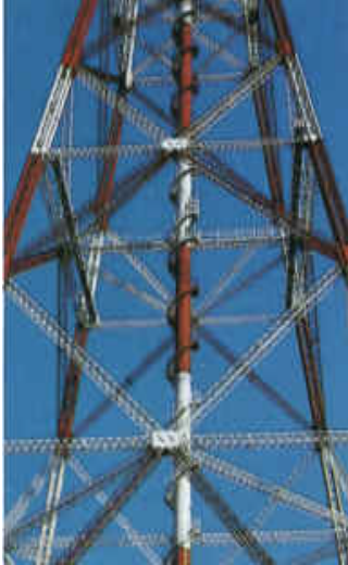
Fig. 2: Torre de transporte de electricidad protegida mediante un sistema duplex. Está situada en Stade, Balo Elba, y es la torre de este tipo más alta de Alemania (227 m).
