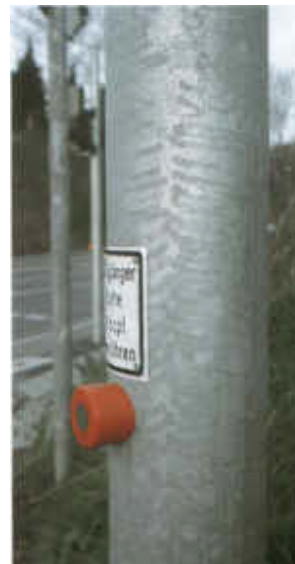
Fig. 2: Manchas blancas ligeras sobre el soporte de una luminaria. Estas manchas se transformarán en poco tiempo en capas protectoras del recubrimiento de zinc por la acción del anhídrido carbónico del aire. Solamente en el caso de querer pintar el soporte sería necesario limpiarlas.
