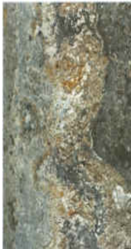
Fig. 4: Manchas blancas profundas con pérdida de una gran parte del espesor del recubrimiento de zinc. Pueden apreciarse incluso corrosiones locales del acero base.
